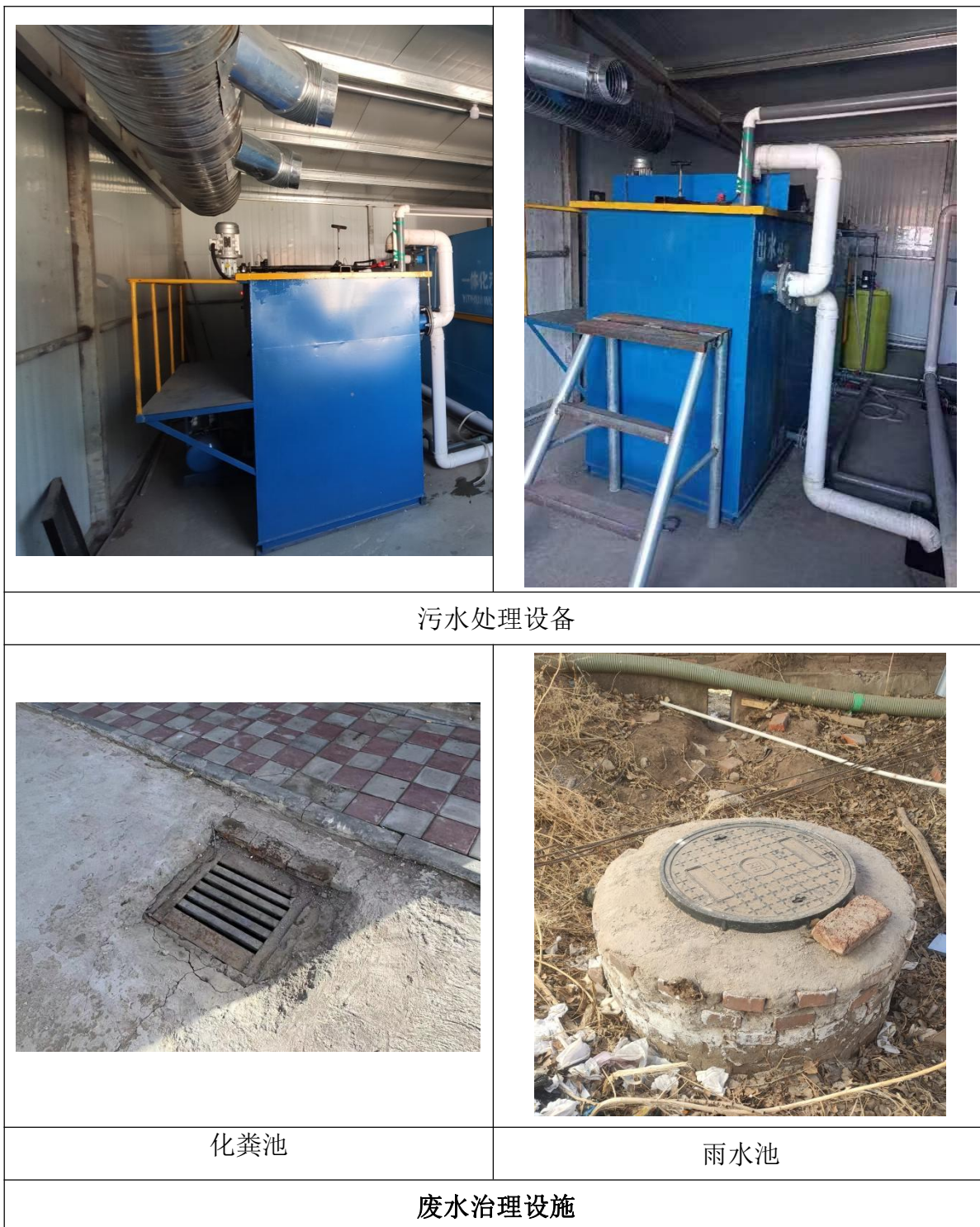
图 3-2 项目废水污染物处理措施现场照片
